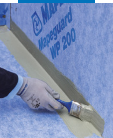
Нанесение Mapeguard WP Adhesive для герметизации стыков в углу перед монтажом ленты Mapeguard ST
